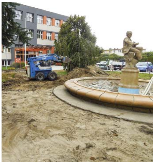
Pracovníci Správy města se přesunuli před ZŠ 9. května, aby zde provedli opravy dešťové kanalizace, kašny a chodníků.
