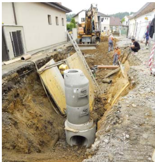
Do další části Táborské ulice se posunula rekonstrukce kanalizačního a vodovodního řadu, chodníků a komunikace.
