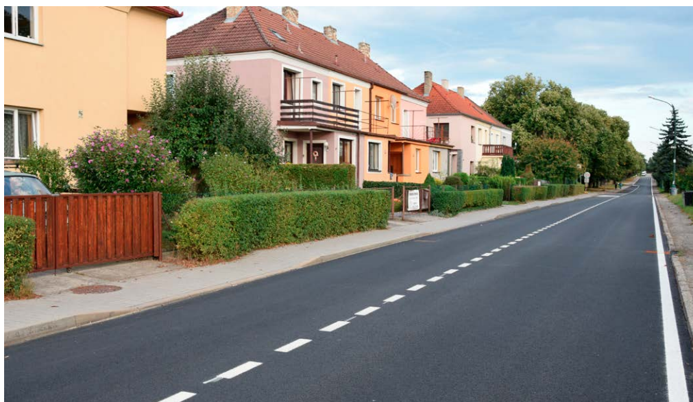
Jihočeský kraj dokončil začátkem září rekonstrukci povrchu silnice III. třídy – ul. Rudé armády a Průmyslová. Foto: Ema Králíková
